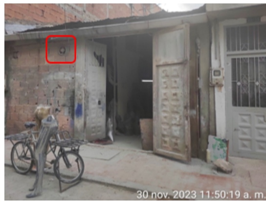
Fotografía 6. Extractor del área de pintura
